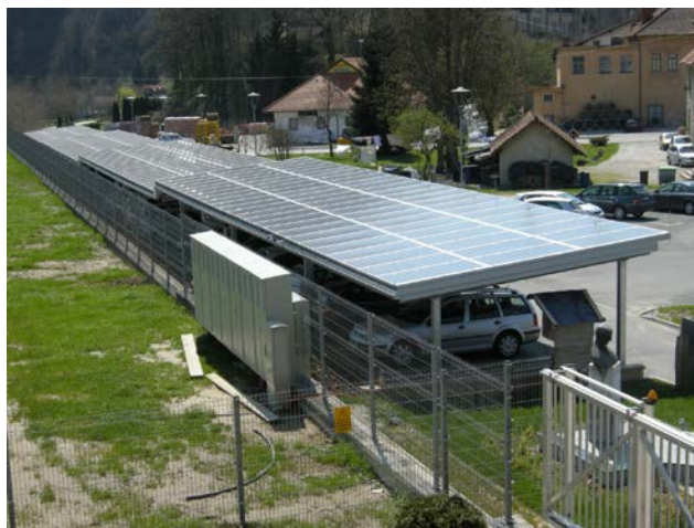
Sl. 3: Mala fotovoltaična elektrarna Termoelektrarne Brestanice d. o. o.
